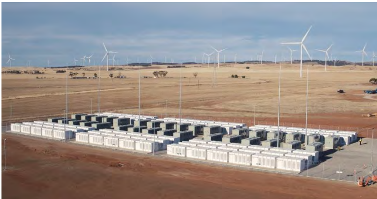
Sistema de almacenamiento de energía por batería Hornsdale, Australia 130 MWh
